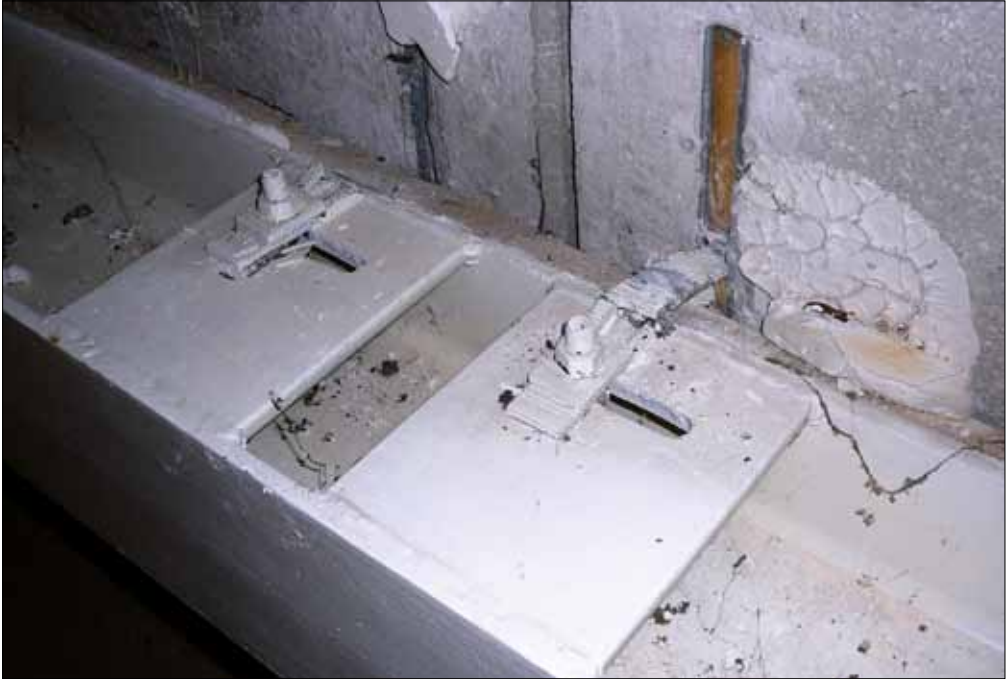
Figura 5.37: Danneggiamento del collegamento faccia orizzontale – faccia verticale fra un pannello e la trave di copertura: fessurazione nel calcestruzzo e rottura dei connettori metallici. Livello di danno nella connessione pannello-struttura: D4 - D5 (terremoto Abruzzo 2009).
