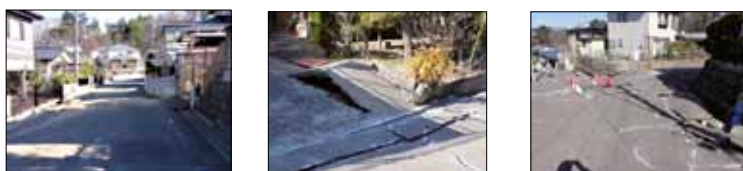
Figura 7.4: Cambiamento di direzione di una strada precedentemente rettilinea (a sinistra) e testimonianze del danneggiamento del manto stradale (al centro e a destra) - Oritate 5-chōme (Giappone 2011)
