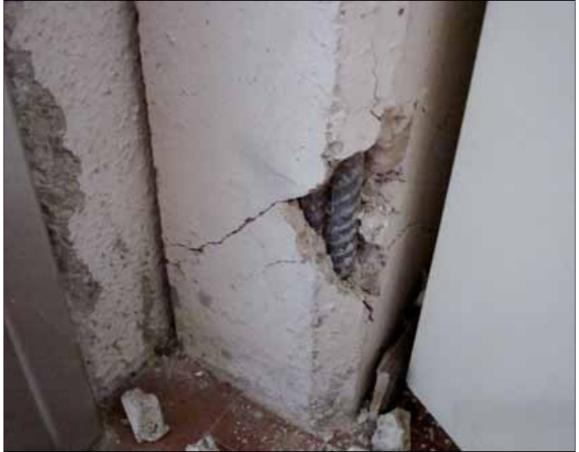
Figura 5.2: Espulsione del copriferro alla base del pilastro a causa della carenza di armature trasversali. Livello di danno nel pilastro: D3 (terremoto Emilia-Romagna 2012)
