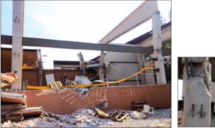
Figura 5.29: Crollo di pannelli orizzontali di tamponamento in un edificio monopiano prefabbricato e dettaglio profili canale di collegamento fra il pannello e il pilastro. Livello di danno nella connessione pannello-struttura: D5 (terremoto Emilia-Romagna 2012)
