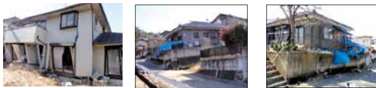
Figura 7.3: Danneggiamento di un edificio (a sinistra) e danneggiamento dei muri di contenimento (al centro e a destra) causati dallo scorrimento del terreno - Oritate 5-chōme (Giappone 2011)
