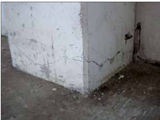
Figura 5.3: Fessurazione alla base dei pilastri di un edificio monopiano prefabbricato. Livello di danno nel pilastro: D2-D3 (terremoto Emilia-Romagna 2012)
