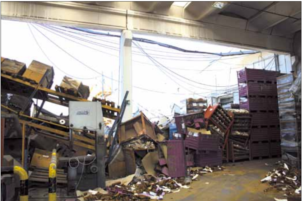
Figura 5.40: Perdita d'appoggio degli elementi di copertura con collasso parziale della struttura. Livello di danno D4-D5 (terremoto Emilia-Romagna 2012, San Felice sul Panaro, MO)
