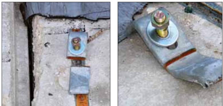
Figura 5.38: Rottura delle piastrelle di ritenuta dei collegamenti tra pannello e struttura. Livello di danno: D4 - D5 (terremoto Abruzzo 2009).
