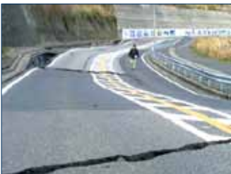
Figura 7.10: Distorsione differenziale della pavimentazione stradale in una zona residenziale di Mihama di Chiba (Giappone 2011)
