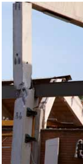
Figura 5.6: Rottura del pilastro in corrispondenza della via di corsa del carroponete con instabilizzazione delle barre longitudinali della trave porta-carroponete. Livello di danno nel pilastro: D4-D5 (terremoto Emilia-Romagna 2012)
