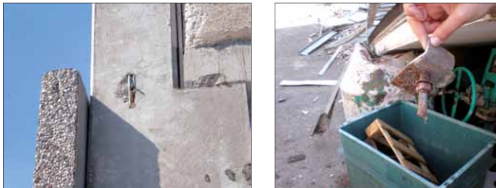
Figura 6.1: Collasso di un pannello prefabbricato orizzontale per crisi a taglio del connettore di acciaio (terremoto Emilia-Romagna 2012, Mirandola (MO))
