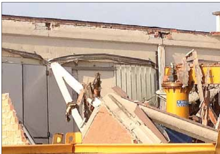
Figura 5.25: Perdita di appoggio di elementi di copertura a shed. Livello di danno nella connessione copertura-trave: D5 (terremoto Emilia-Romagna 2012)
