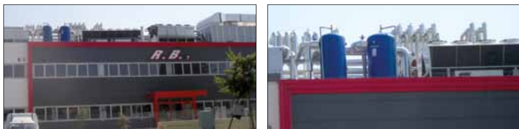
Figura 4.37. Macchinari pesanti e di varia natura sulla copertura di una struttura prefabbricata.
