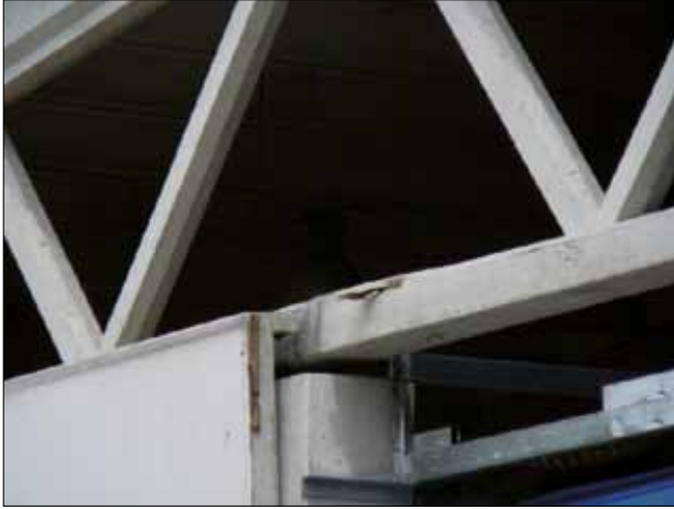
Figura 5.32: Rottura dei collegamenti pannello-struttura di un edificio prefabbricato pluripiano. Livello di danno nella connessione pannello-struttura: D4 - D5 (terremoto Abruzzo 2009, Autoparco comunale, L'Aquila)
