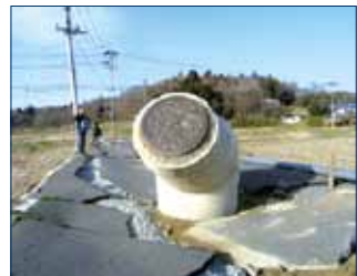
Figura 7.9: Sollevamento di un tombino e contemporanea subsidenza del terreno con pesante danneggiamento del manto stradale a Sukagawa di Fukushima (Giappone 2011)
