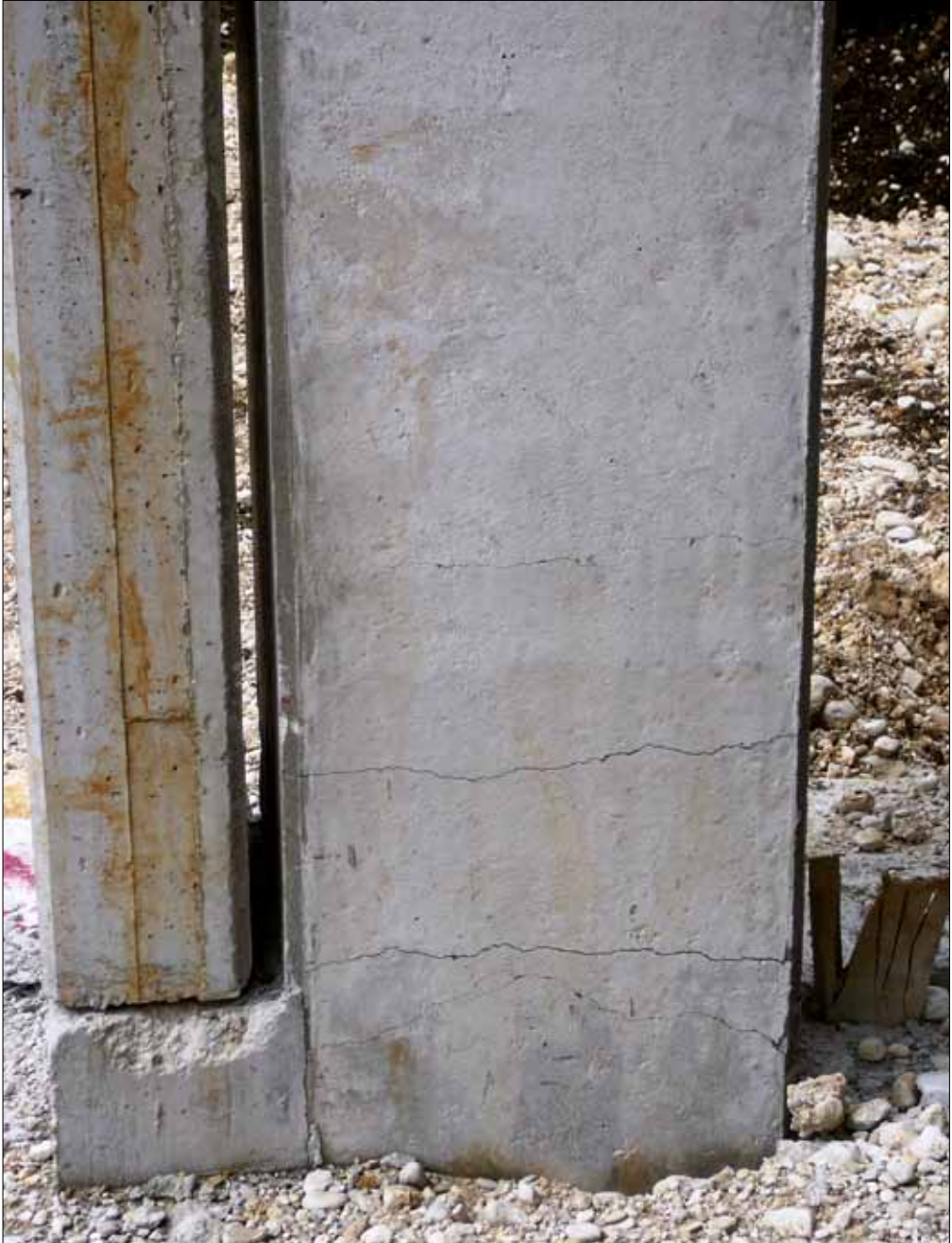
Figura 5.36: Danneggiamento locale alla base del pilastro e del pannello. Livello di danno nella connessione pannello-struttura: D3 (terremoto Abruzzo 2009).
