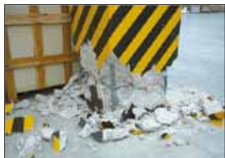
Figura 5.4: Sviluppo della cerniera plastica con espulsione di copriferro ed instabilizzazione delle barre longitudinali di armatura alla base di un pilastro di una struttura monopiano. Livello di danno nel pilastro: D4 (terremoto Emilia-Romagna 2012)
