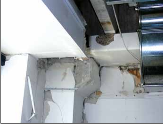
Figura 5.19: Danneggiamento locale nel pilastro e nella mensola di un edificio a struttura prefabbricata. Livello di danno nella connessione trave-pilastro: D3 (terremoto Abruzzo 2009).
