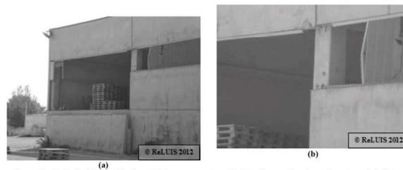
Figura 28 - (a) Crollo dei pannelli orizzontali di tamponamento e (b) dettagli connessione in corrispondenza del pilastro
