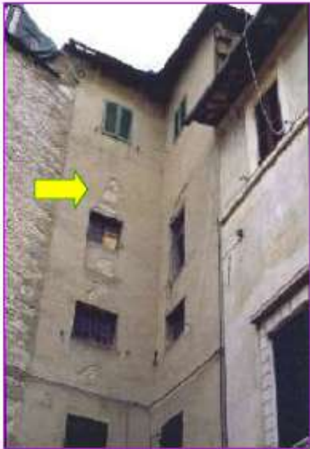
Distacchi di intonaco
