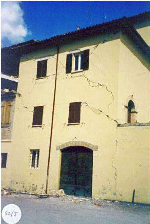
Lesioni diagonali nei maschi murari
