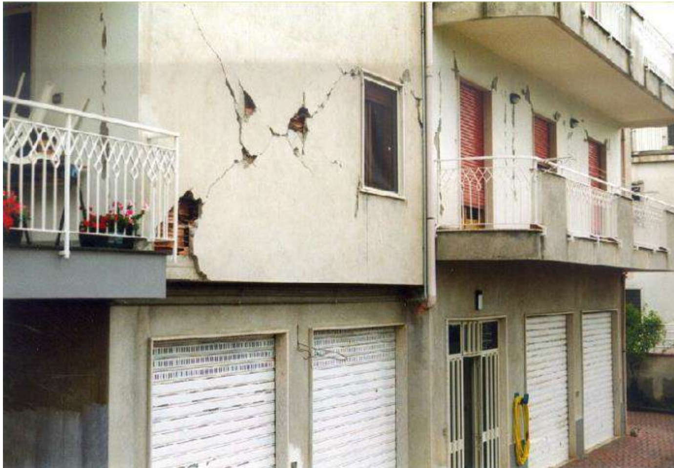
Diffusi danni alle tamponature
