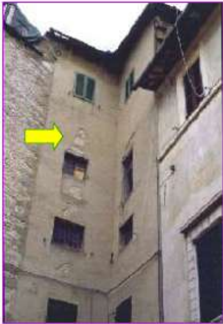
Distacchi di intonaco
