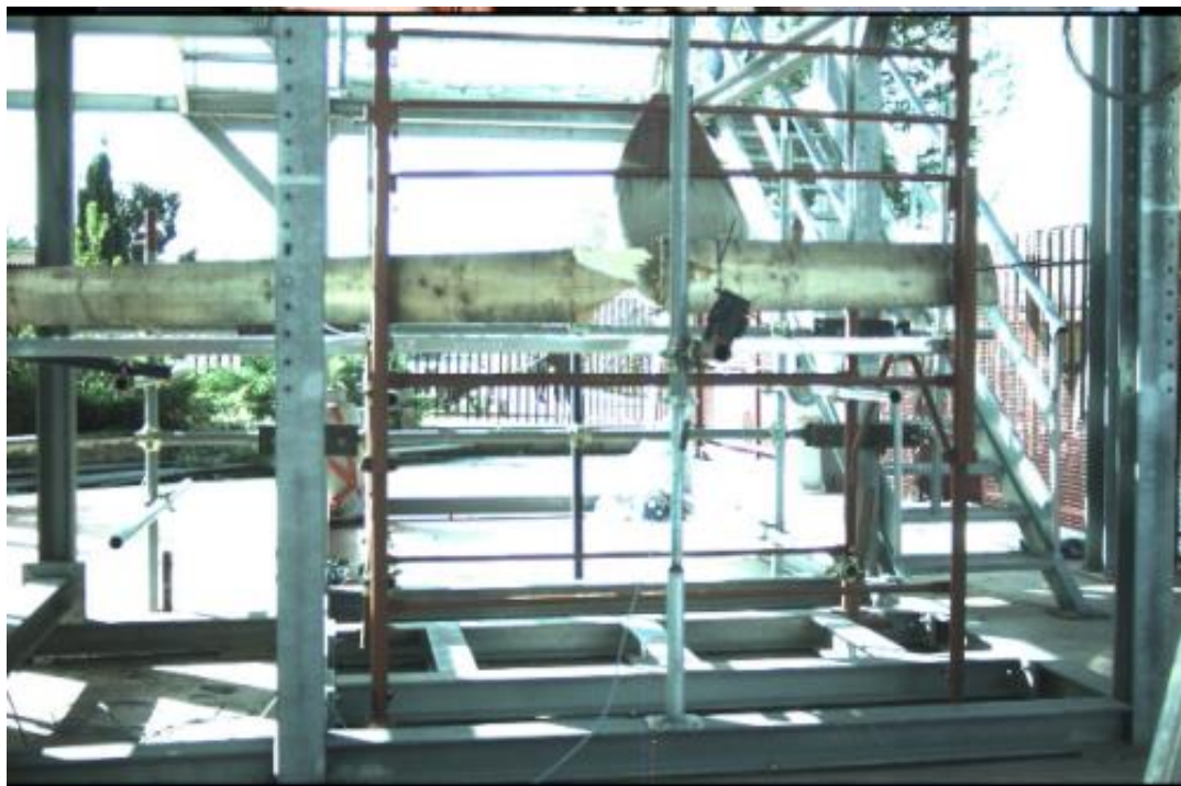
Criticità nella tavole in legname 20x5 cm prive di certificazione comunemente utilizzate in cantiere
