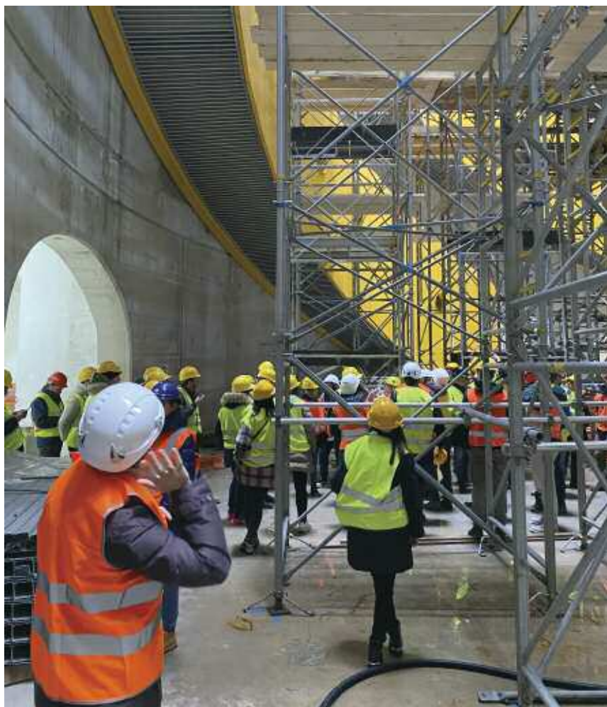
Il gruppo di ingegneri nel cantiere della Stazione di Capodichino dalla quota del piano rotabile (Fotografia di Massimo Palombo)
